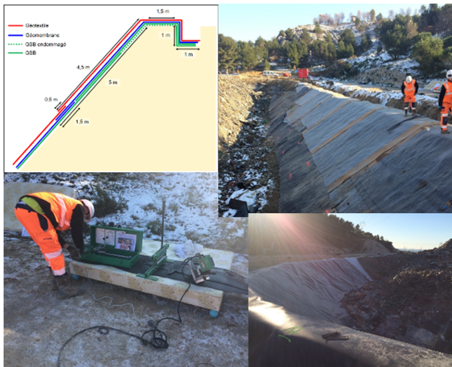
Travaux de réparation du dispositif d'étanchéité de l'alvéole n°2 (ISDND du Vallon du Fou)
