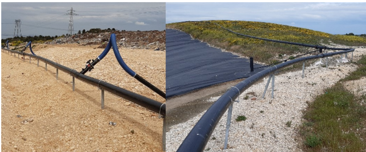
Dispositif de captage du biogaz – Alvéole n°2 (ISDND du Vallon du Fou)
