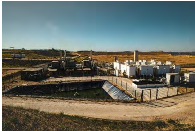
Plateforme de valorisation du biogaz
