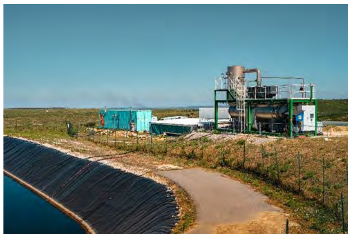
Station de traitement des lixiviats
